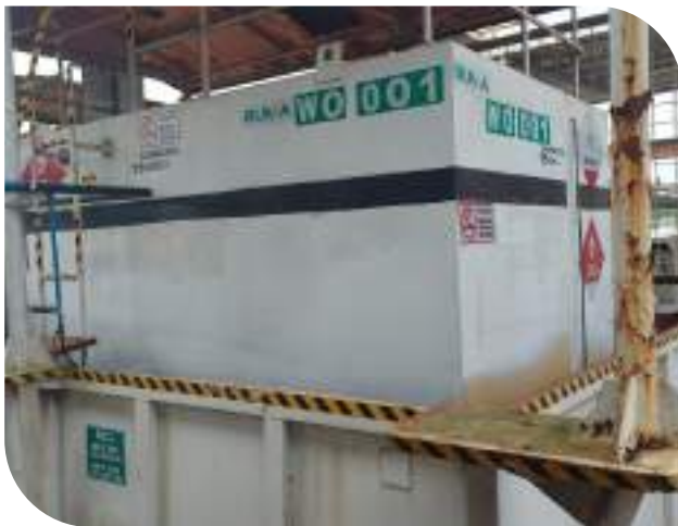
Used lubricant storage tank Tangki penampungan oli bekas
